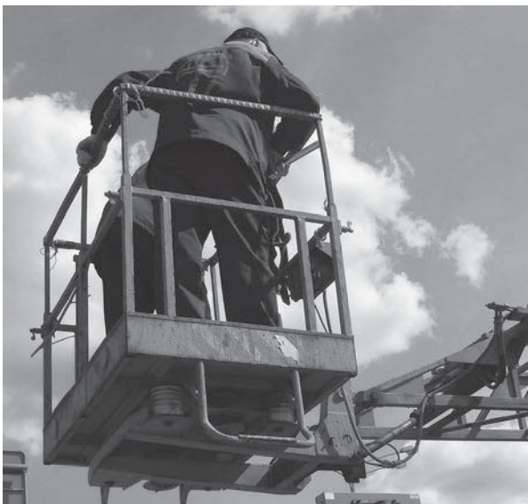
Монтажная площадка на изоляторах – для безопасности
